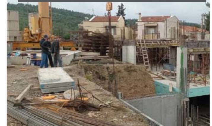
Βρεφονηπιακός Σταθμός Πεύκων: Από την θεμελίωση τον Σεπτέμβριο (επάνω) στην εξέλιξη των εργασιών και τη σημερινή εικόνα (κάτω).
